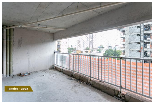
Foto 4 - Parapeito de sacada
