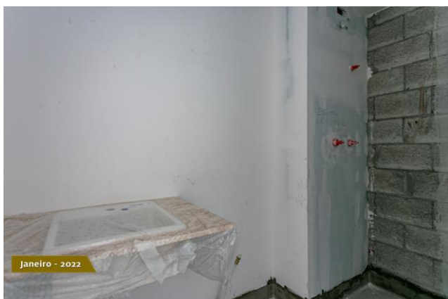
Foto 1 – Bancada com cuba instalada, detalhe de pontos hidráulicos em parede.
