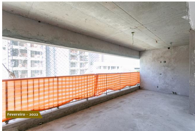
Foto 4 – Parapeito de sacada
