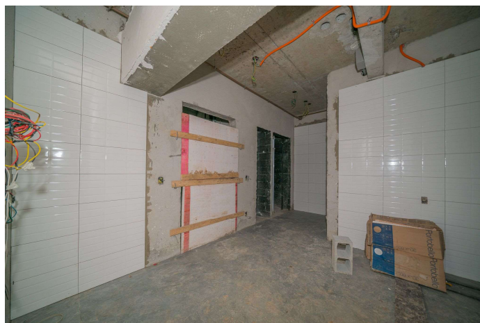
Foto 4 - Fase de acabamentos em área comum interna.
