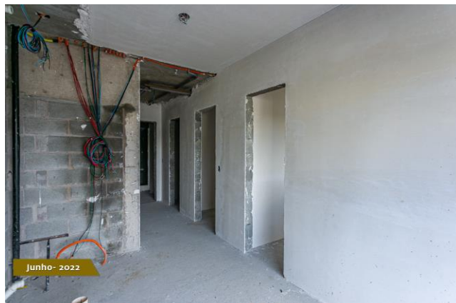
Foto 2 - Instalações Elétricas e Tubulações em unidade.
