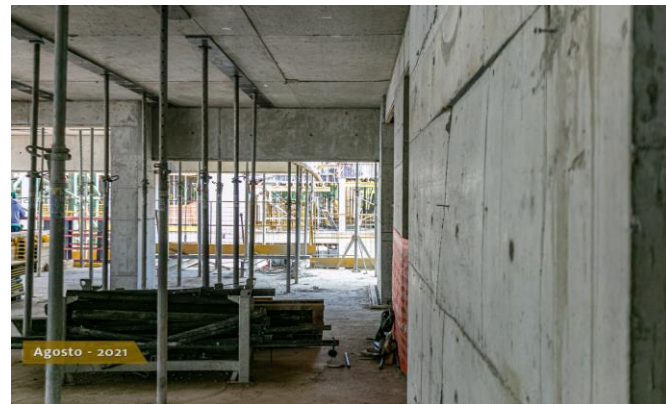
Foto 4 – Os primeiros pavimentos apresentam lajes e vigas construídas, em fase de escoramento.
