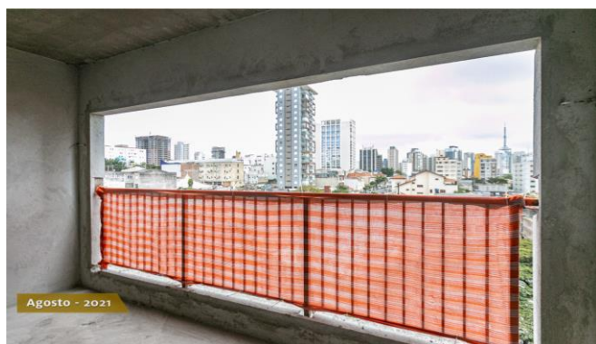
Foto 1 - Grade de contenção de sacada instalado.
