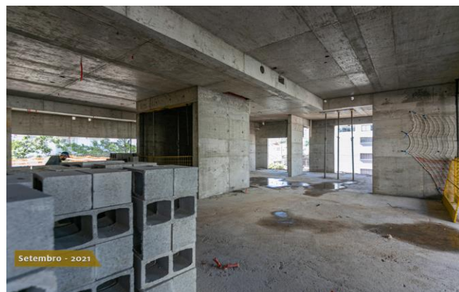
Foto 2 – Pavimento com laje de concreto finalizada, detalhe para blocos de concreto a serem utilizados em alvenaria.
