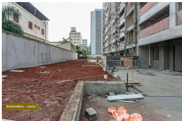
Foto 2 – Dutos elétricos em área externa de jardim.
