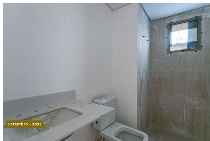
Foto 4 - Acabamento e louças em banheiro de unidade.
