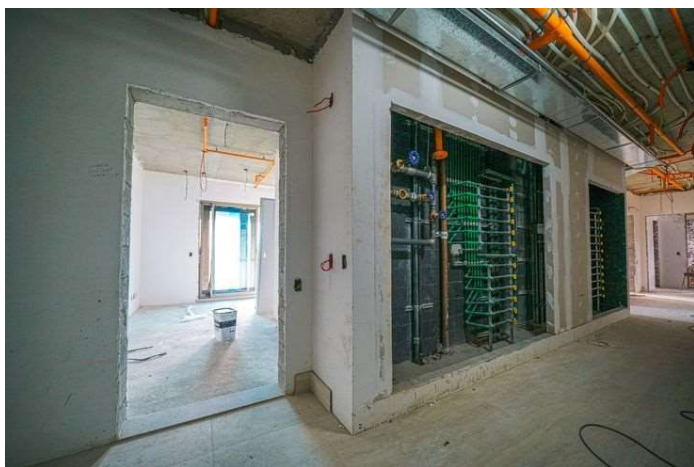
Foto 3 - Shaft e hidráulica do empreendimento.
